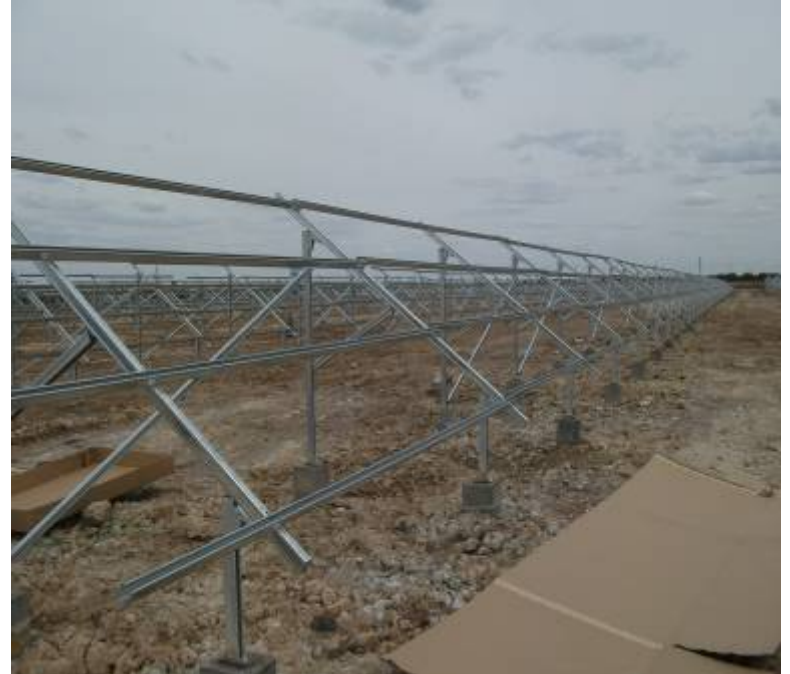
宁夏平罗10MW光伏电站
