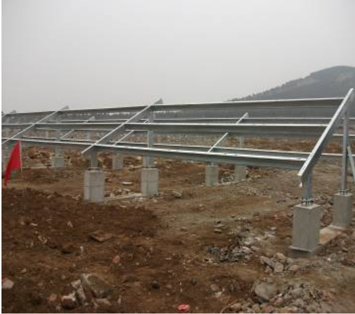
徐州20MW光伏电站
