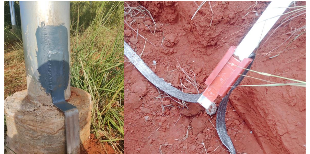
光伏支架接地
