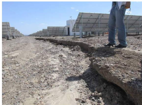
厂区南北纵向路受损
