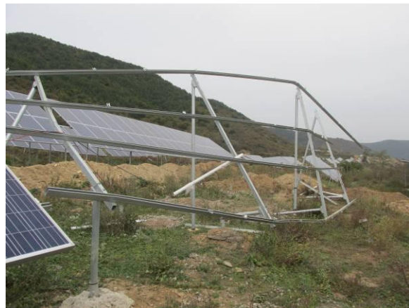
阵列支架系统整体变形/组件脱落
