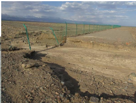
环厂主干道损情况 /洪水冲击沟
