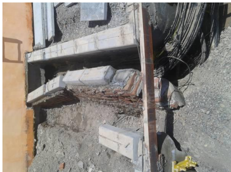
升压站电缆沟坍塌
