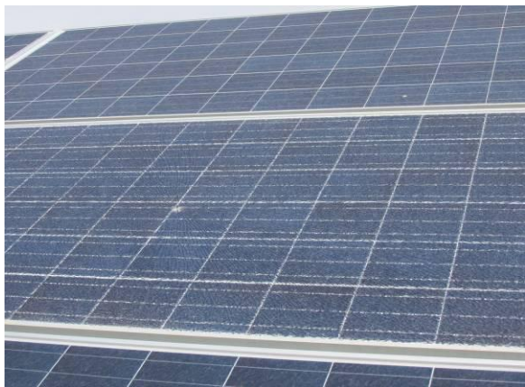
光伏组件受支架变形牵拉影响碎裂
