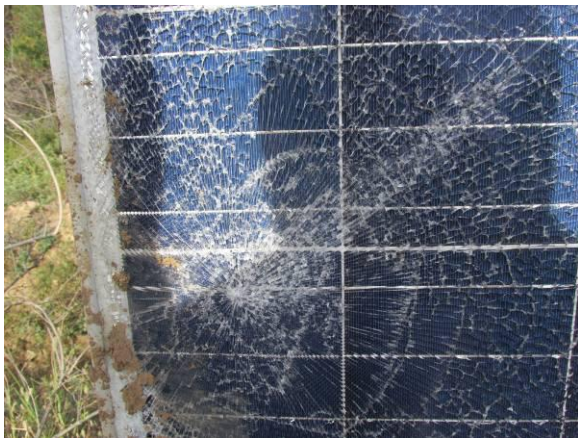
组件面板风吹落地后碎裂
