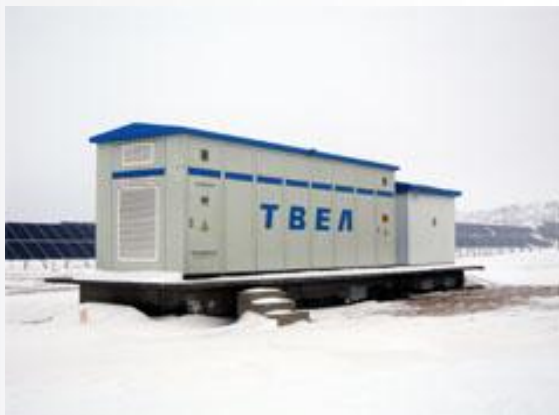
阿勒泰地区青河20MW项目:冬季最低-53°C
