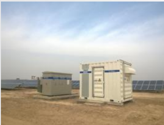
印度79MW项目
