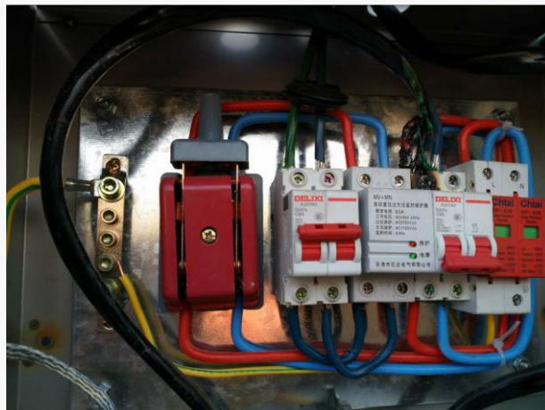
电线虚接导致烧坏
