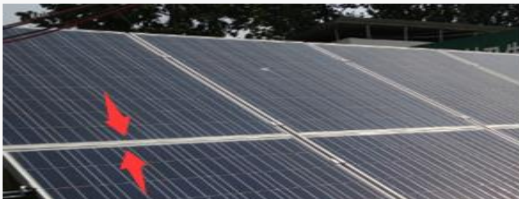
图 4-22 非正常安装组件图例
