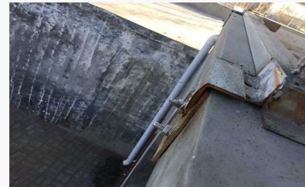
焊渣未清理，有锈蚀
