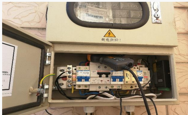
配电箱走线凌乱
