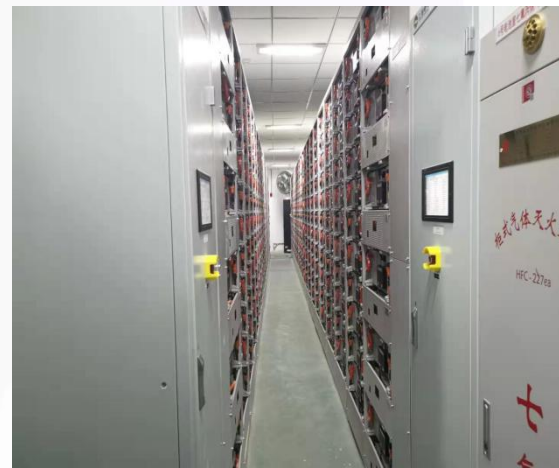
上海电气格尔木美满闵行储能电站
