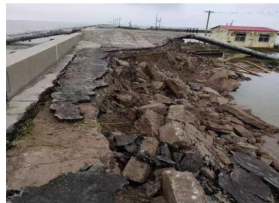
山东省东营市河口养殖区道路损毁
